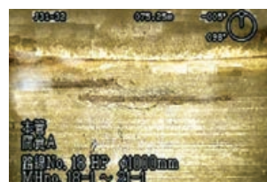
管内腐食による鉄筋露出
