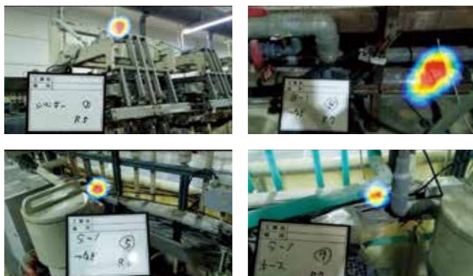
圧縮空気漏れ検知カメラによるエアリー漏れ調査（診断報告書より）
