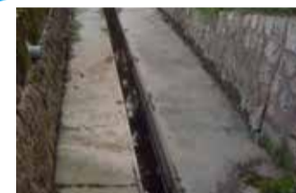
流れの悪い側溝
