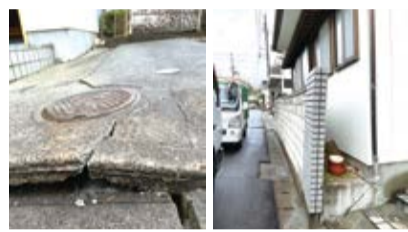
▲能登半島地震の被害
