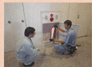
消防設備点検
