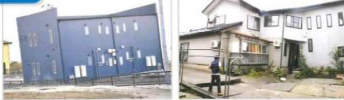
沈下及びび一体傾斜(左)、変形傾斜(右)など
