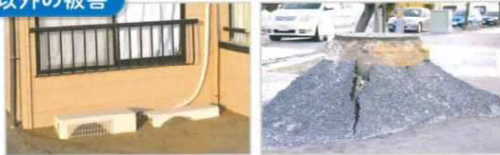
傾斜や噴砂による埋没(左)、敷地内の排水管やガス管などの破損・詰まり、マンホールの浮き上がり(右)など
