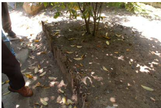
図3-12 土留めの劣化と表土の状況
