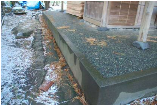
図3-32 待合の軒内（復旧前）
