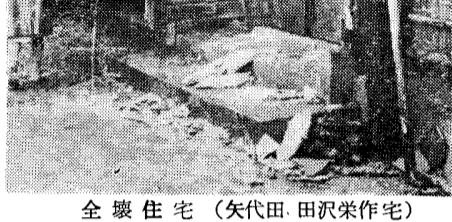
全壊住宅 (矢代田 田沢栄作宅)
