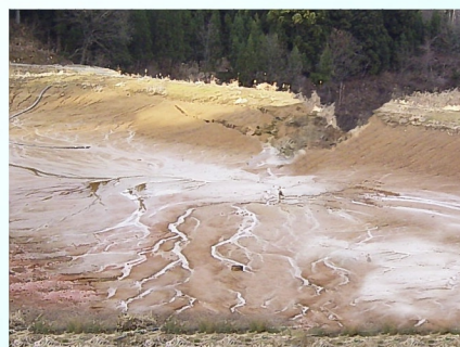
被災したため池（新潟県中越地震）
