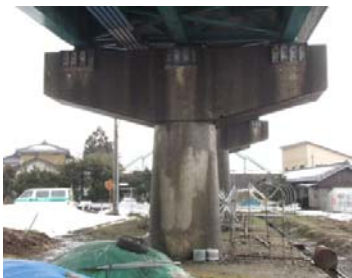
現在の基準を満たしていない橋脚 (昭和55年より古い基準)
