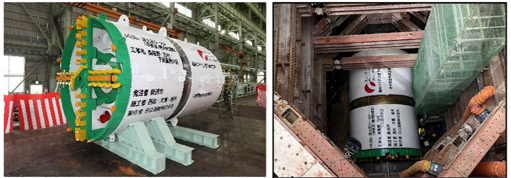
シールドマシンは地下約20mより掘削します。 地中を掘削しながら、管路を構築します。
