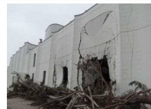
【津波の被害状況】
