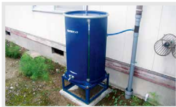
【貯留タンク設置例】
