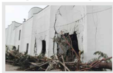
【津波の被害状況】
