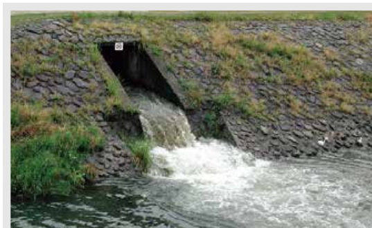
【雨水と一緒に放流される未処理下水】
