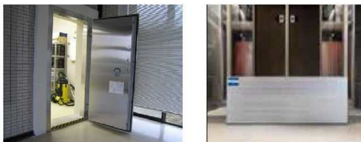
【建物内への浸水防止策（左：耐水扉 右：止水板）】
