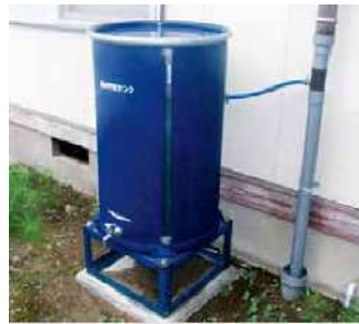
雨水貯留タンク
