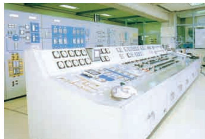
青山浄水場の中央監視室
