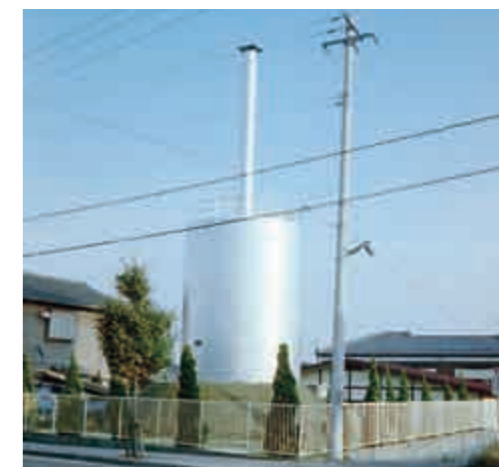
青山浄水場～南山配水場間の調圧水槽(浦山地内)
