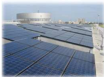
信濃川浄水場（100kw）
