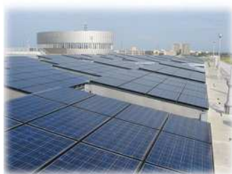
信濃川浄水場（100kw）
