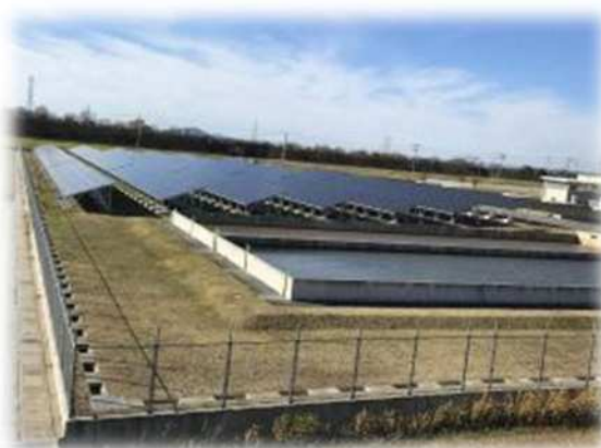
満願寺浄水場（645kw）
