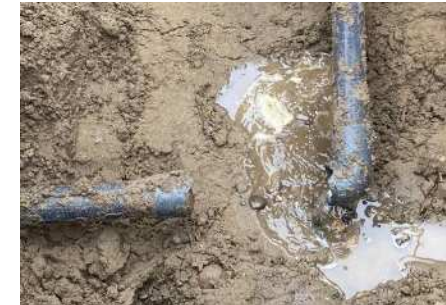
配水管の損傷状況
