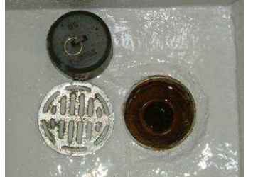
風呂排水口トラップ
