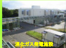
消化ガス発電施設
