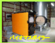
バイオマスボイラー
