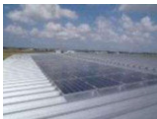
【屋根】太陽光パネル
