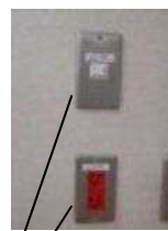
【教務室】 非常用コンセント 非常用照明
