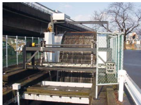
■図-23 姥ヶ山排水路除塵機
