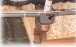
雨どいの目詰まり
