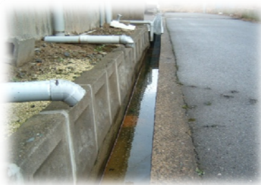
流れの悪い側溝
