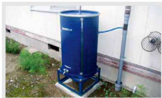
【貯留タンク設置例】
