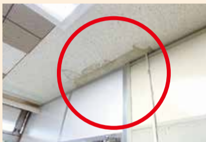
▲複数箇所からの雨漏り(室内)
