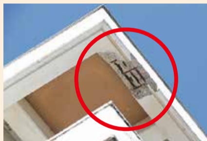
▲B棟南側玄関から見た軒下コンクリートの一部落下
