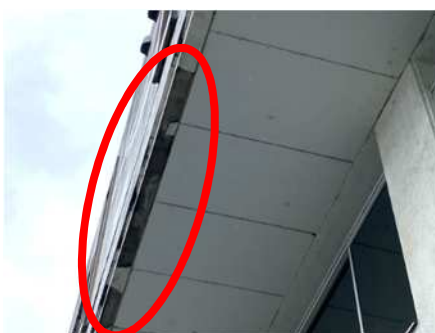
▲おもいやり駐車場から見た軒下 コンクリートの一部落下
