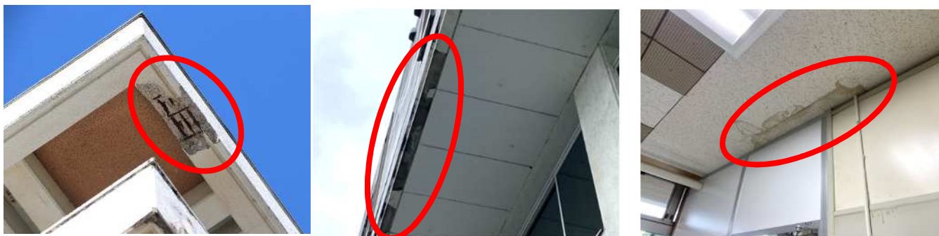
▲B棟南側玄関から見た軒下 コンクリートの一部落下
