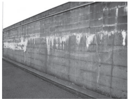
高さがあり危険性が確認された通学路のブロック塀
