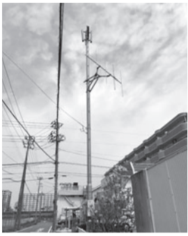
津波対策として設置されている同報無線(中央区)
