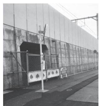
高架下に整備中の区画道路入口付近(西跨線橋から約250m東側)
