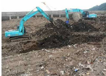
重機による災害廃棄物の山の掘削 岩手県宮古市田老一次仮置場
