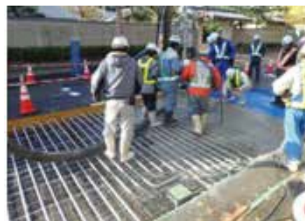
車道融雪設備設置状況
