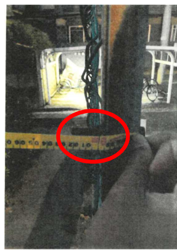
ボルト突出状況
