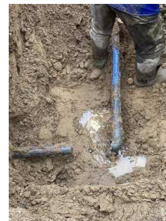
配水管の損傷状況
