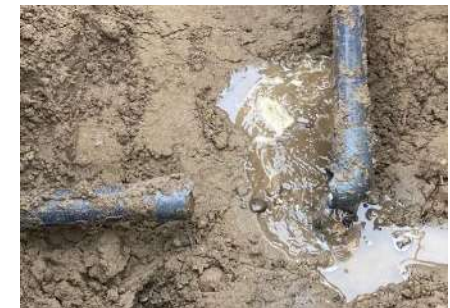
配水管の損傷状況
