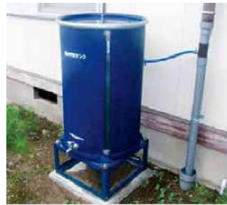
雨水貯留タンク
