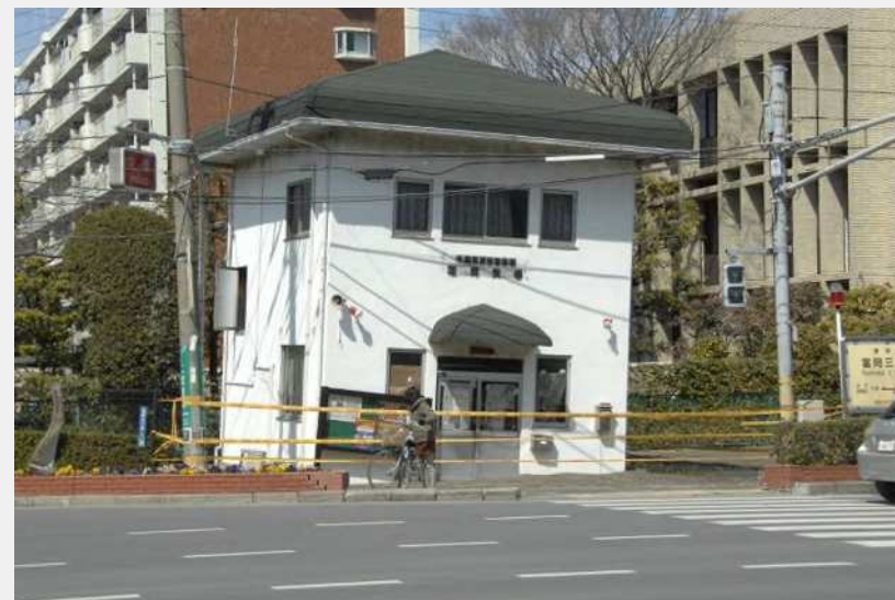
富岡交番の傾斜被害
