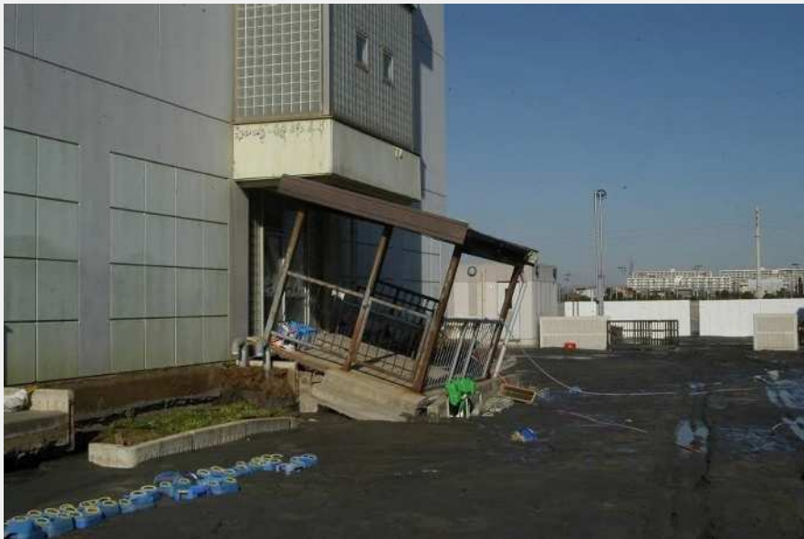
明海小学校の液状化
