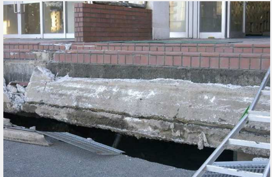
市内私立学校玄関の陥没
