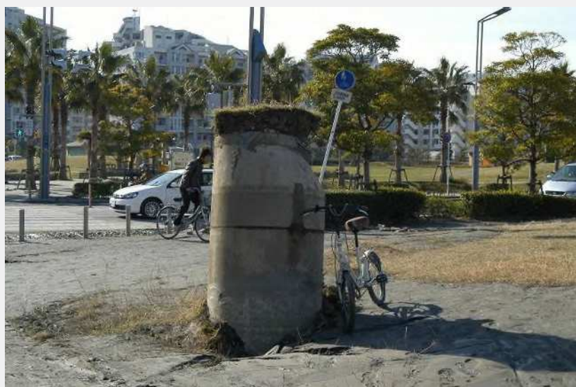
明海地区のせり上がったマンホール
