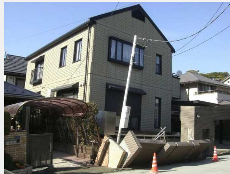
戸建住宅の傾斜
