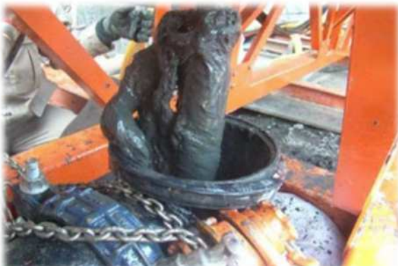
H29 舞浜地区 ドレーン材が施工機械にからみつく
