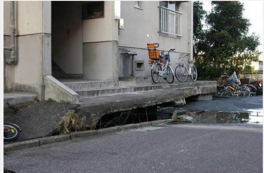
高洲地区警察官舎の陥没
