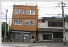
①住宅の沈下・傾斜
