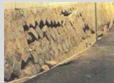
③擁壁の崩壊
