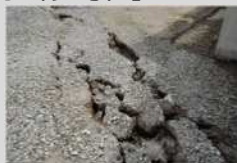
②地盤の亀裂
