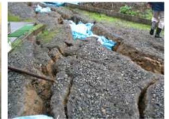
地盤の亀裂 (出典：被災宅地の調査・危険度判定マニュアル/被災宅地危険度判定連絡協議会)
