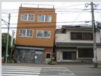
住宅の沈下・傾斜
