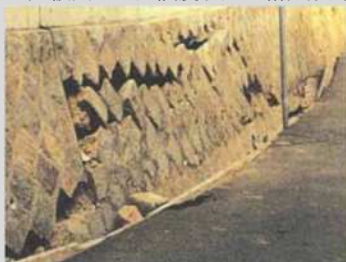
擁壁の不同沈下・目地の開き
