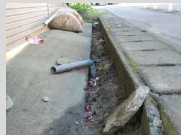
地盤の沈下・段差
