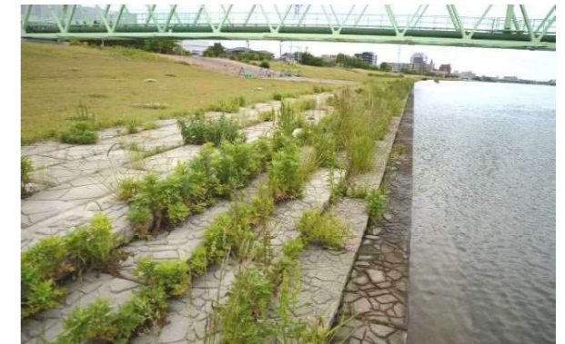
■目地に侵入した雑草が、荒廃した印象を与えており、居心地の良い水辺空間とはなりにくい。
