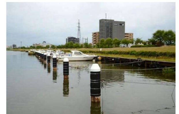
■矢板護岸前面が繫船場として利用されている。古タイヤの防舷材や錯綜するロープ等が、荒廃した雰囲気を生み出しやすい。
