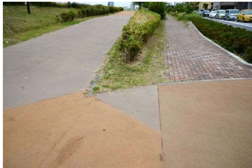
■施工年次の違いにより、舗装材や色彩がツギハギ状になっている箇所もある。
