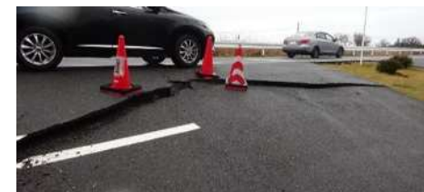
地震による被害
